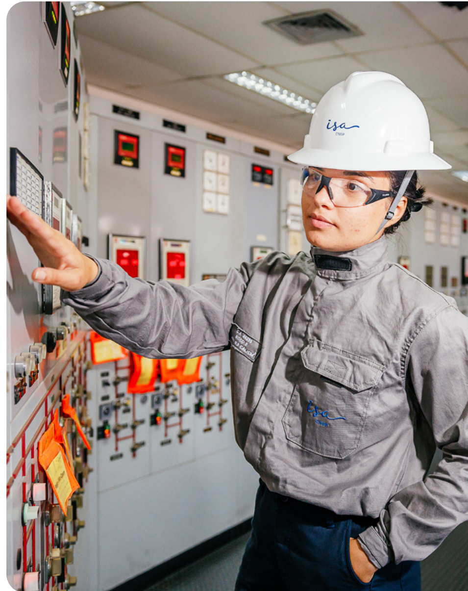
— Natália Beatriz Pereira Nascimento Sorreano, Substation and Installation technician, at the Bom Jardim unit
